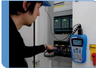
Prüfen der Impedanz an der Schaltschränken.
